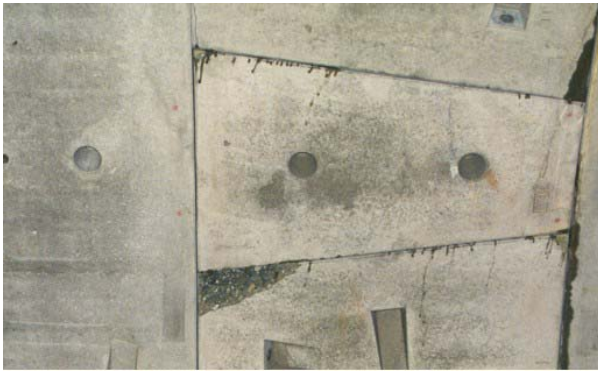
figuur 4, Schade aan tunnelementen
