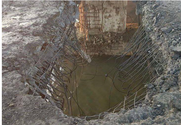
Figuur 6.1: Beschadigde brug in de Krim, de Chongar brug [9].
