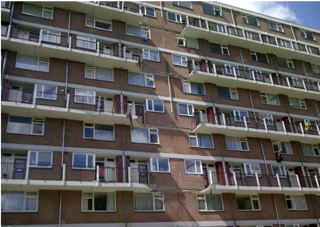
Antillenflat in Leeuwarden, de ingestorte galerijplaten.
