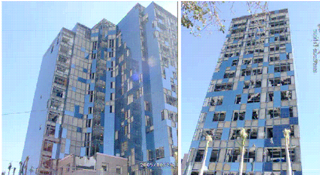
Figuur 4.1, schade door wind op een gebouw in Florida
